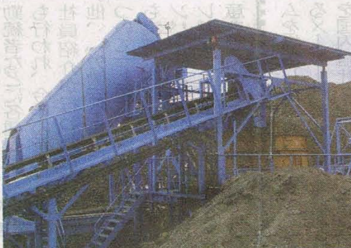
混練・造粒固化施設
